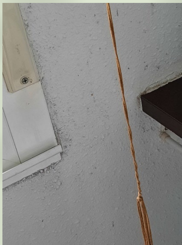
Abbildung 3: Verschimmelte Ecke am Fenster
