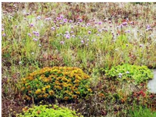
Abbildung 35. Beispiel einer extensiven Dachbegrünung mit Sedum- und Kräutergesellschaften (Quelle: Hochschule Koblenz/Kirchner)
