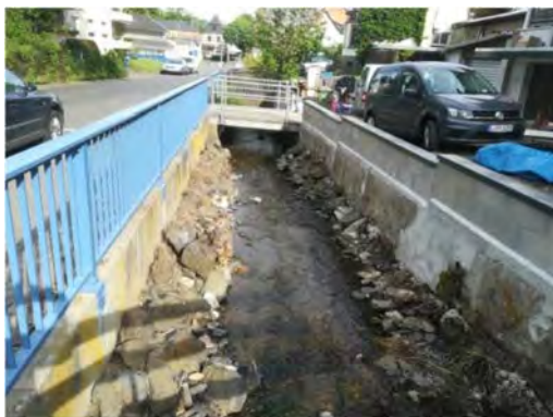
Abbildung 83 Boppard, Mühlalbach, vermauerte Ufer, kein Zugang, enger Brückendurchlass. (Quelle: Hochschule Koblenz/Kaspar 2020)
